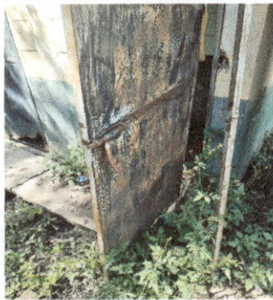
Foto 3: MODULO A SERVICIO SANITARIO vista de puerta de metal es servicio sanitario a ser reemplazada.
