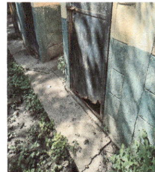
Foto 4: MODULO A SERVICIO SANITARIO Vista de puertas en mal estado a ser reemplazadas
